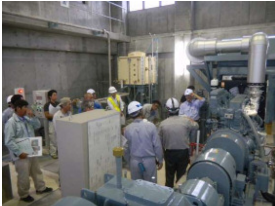
関上排水機場(操作説明会の様子)
