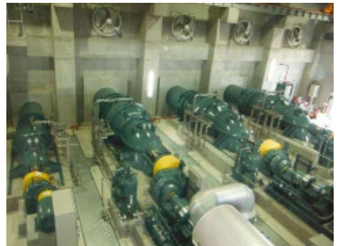
寺野排水機場(内部の様子)
